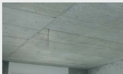
Betonfläche mit erhöhter Restfeuchte.
