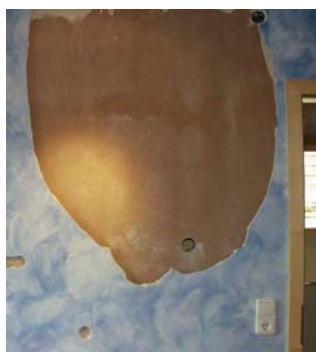
Trotz Haftbrücke hat sich der Putz gelöst.
